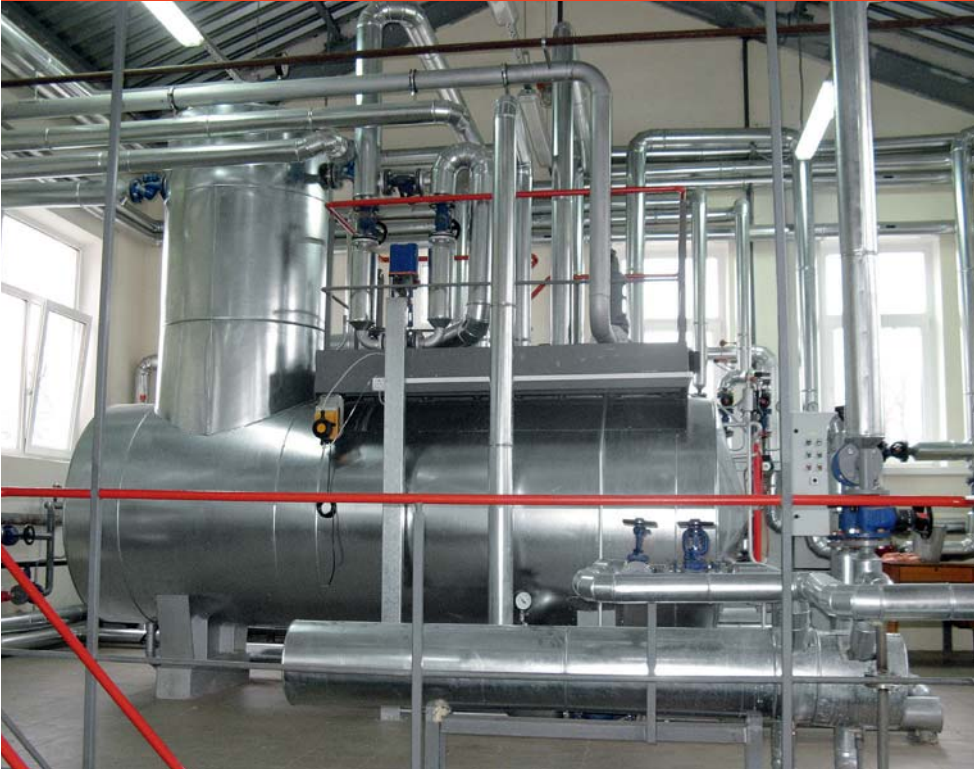
Abb. D.5.3-2 Thermische Vollentgasungsanlage
