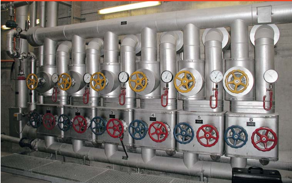
Abb. D.8.5.1-3 Dampfverteiler
