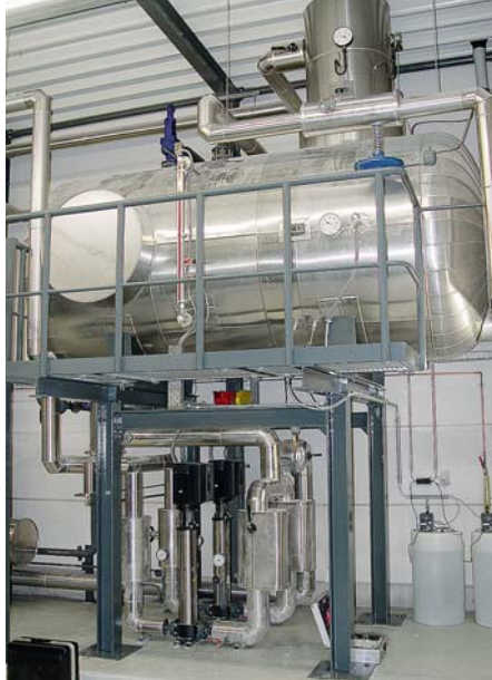
Speisewasserbehälter mit aufgesetztem Rieselentgaser
