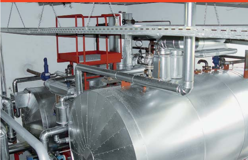
Abb. D.5.1.1-2 Hochdruck - Kondensatsammelbehälter
