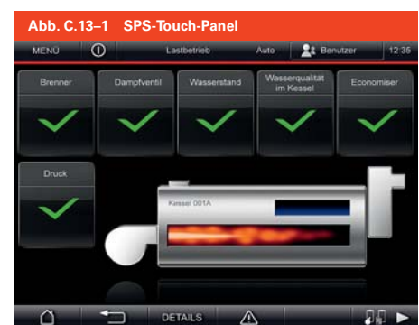
SPS-Touch-Panel Schaltschrank Vitocontrol
