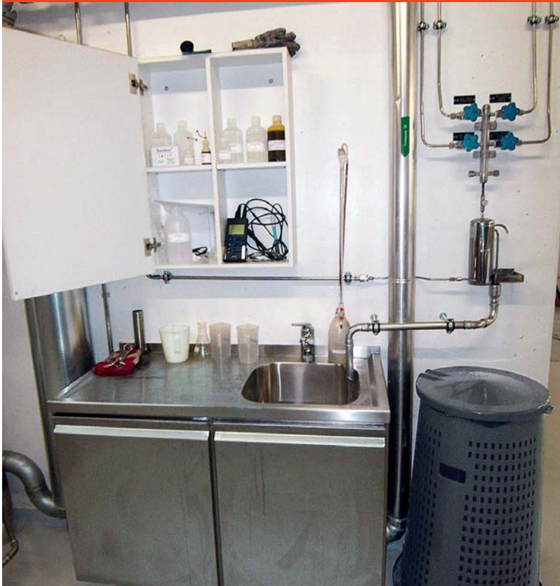
Abb. D.75.1-1 Arbeitsplatz zur Auswertung der Wasserproben von Speise- und Kesselwasser
