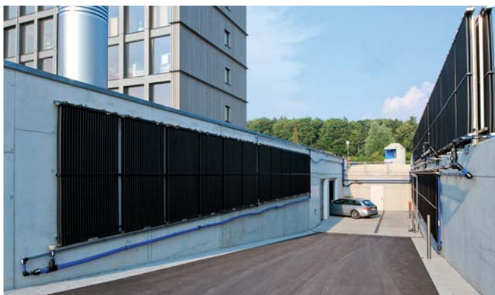
Platzsparender Solar/Luftabsorber- Zaun an der Einfahrt zu einer Tiefgarage
